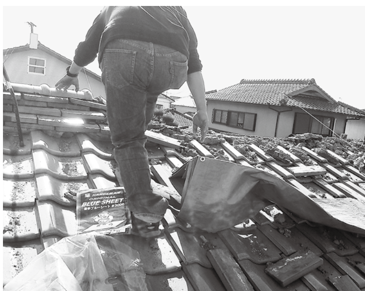
屋根瓦の破損に伴い、屋根にブルーシートをかけて応急処置を行った
