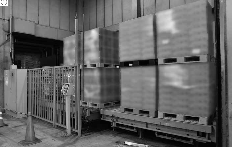
倉庫内に設置された垂直搬送機には一挙にパレットが4枚搭載可能
