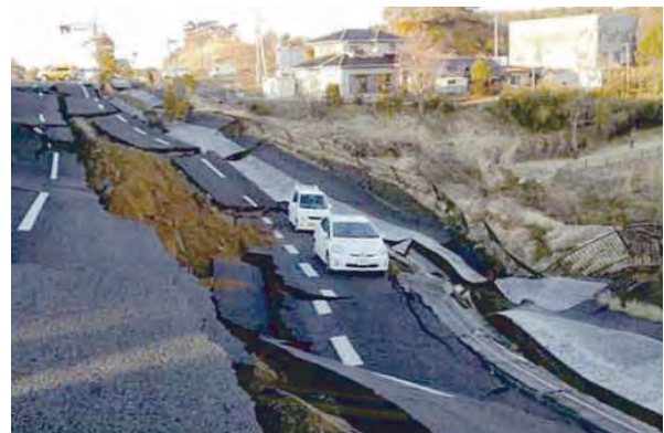
国道 6 号 路面崩壊（福島県広野町） 資料：国土省東北地方整備局
