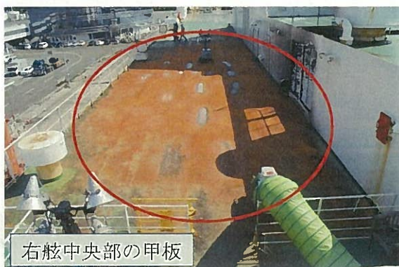
写真3 第4甲板右舷中央部の損傷状況
