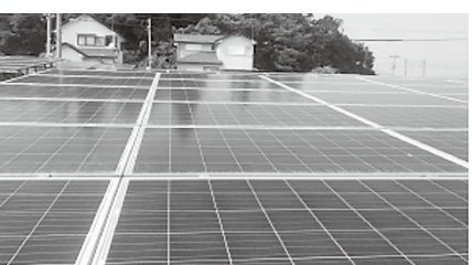
再生可能エネルギーの活用を図るため、太陽光パネルを設置した
