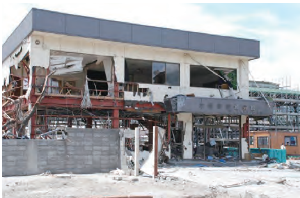
全壊した岩手県トラック協会大船渡研修会館(岩手県大船渡市)
