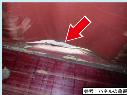
参考：パネルの亀裂
