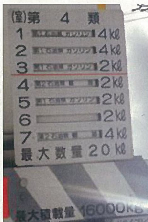
写真4 危険物表示状況
