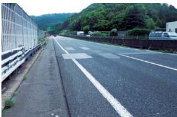
舗装損傷状況
