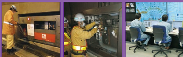
泡消火栓点検
