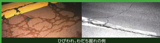
ひびわれ、わだち掘れの例
