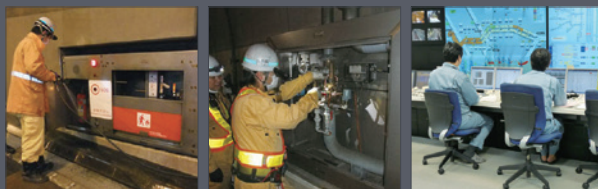
泡消火栓点検
