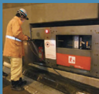
泡消火栓点検
