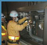
水噴霧装置点検
