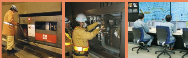
泡消火栓点検
