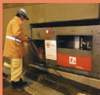
泡消火栓点検
