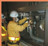
水噴霧装置点検
