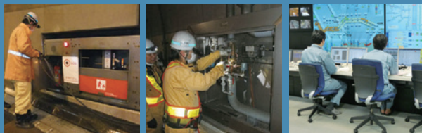
泡消火栓点検
