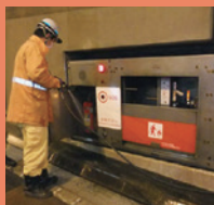
泡消火栓点検
