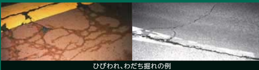
ひびわれ、わだち掘れの例
