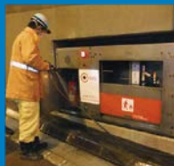
泡消火栓点検
