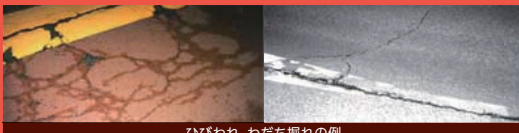
ひびわれ、わだち掘れの例
