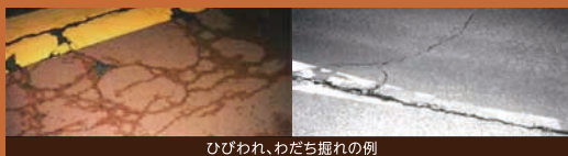
ひびわれ、わだち掘れの例
