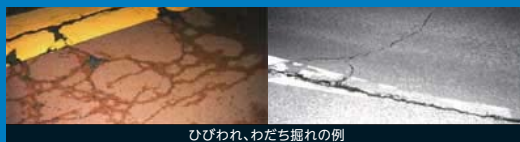
ひびわれ、わだち掘れの例
