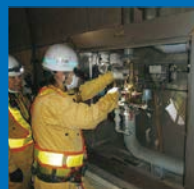
水噴霧装置点検
