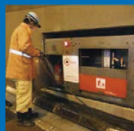
泡消火栓点検
