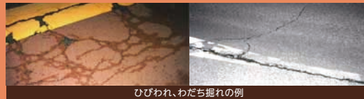
ひびわれ、わだち掘れの例
