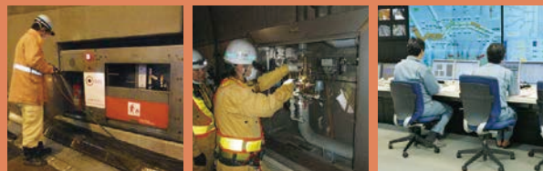
泡消火栓点検
