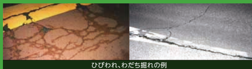
ひびわれ、わだち掘れの例
