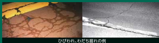
ひびわれ、わだちぬれの例
